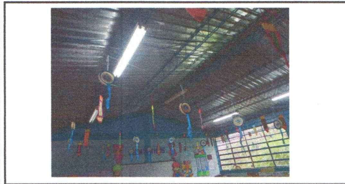
Foto 5: iluminación de aulas en mal estado
